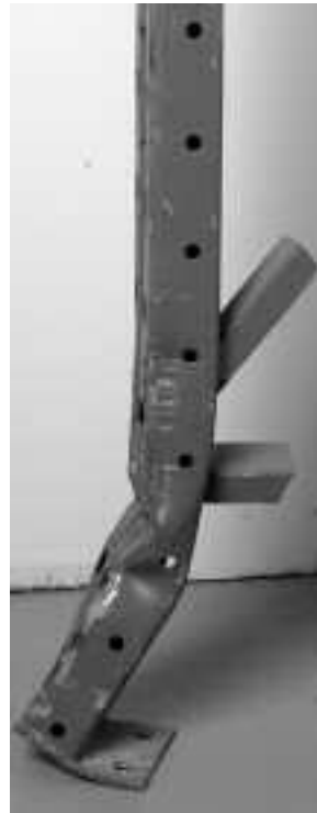
Figure 51b. Même montant endommagé (Vue de côté)
