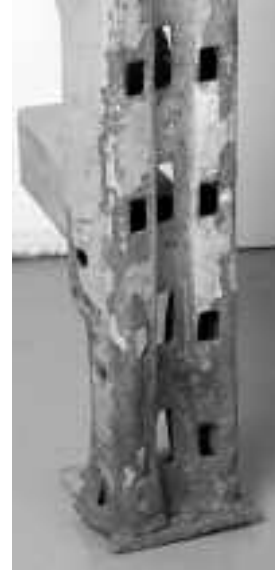
Figure 55. Montant en acier corrodé, usé par frottement et ressoudé (Photo : Maurice Vézinnet)
