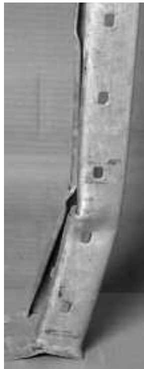
Figure 52b. Même montant endommagé (Vue de côté)
