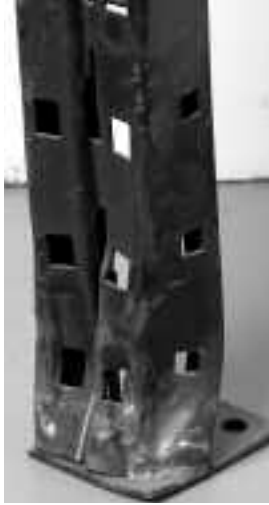
Figure 53. Montant endommagé: la soudure à la hauteur de la plaque de pied d'échelle a cédé (Photo : Maurice Vézinnet)
