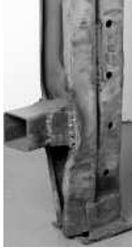
Figure 54. Montant double endommagé: soudure non conforme, usure et déformation du montant causées par le frottement des longerons du chariot élévateur (Photo : Maurice Vézinnet)
