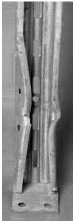
Figure 52a. Montant en acier galvanisé endommagé par des impacts à l'arrière (Vue de l'arrière)
