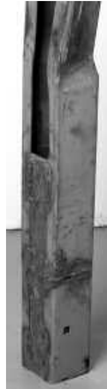
Figure 57. Montant endommagé et réparé par une soudure à l'électrode (Photo : Maurice Vézinnet)
